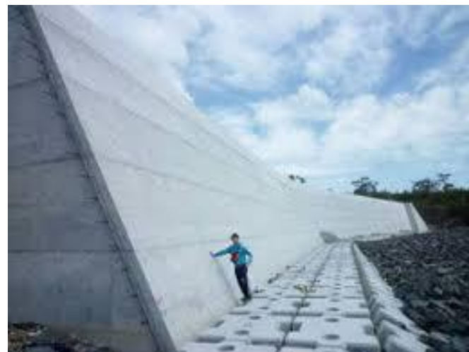
仙台市荒浜港付近
